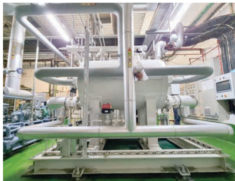
Instalación de la bomba de calor en el interior del CPA de Mérida
