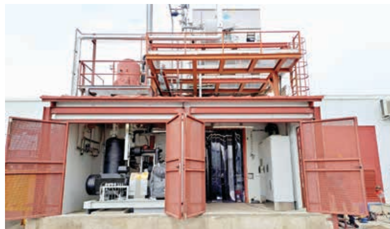
Bomba de calor recientemente instalada en el CPA de Ávila
